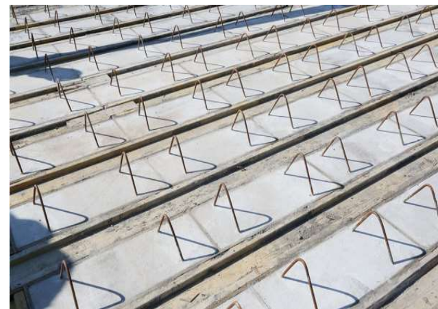
预制盖板混凝土外观质量
